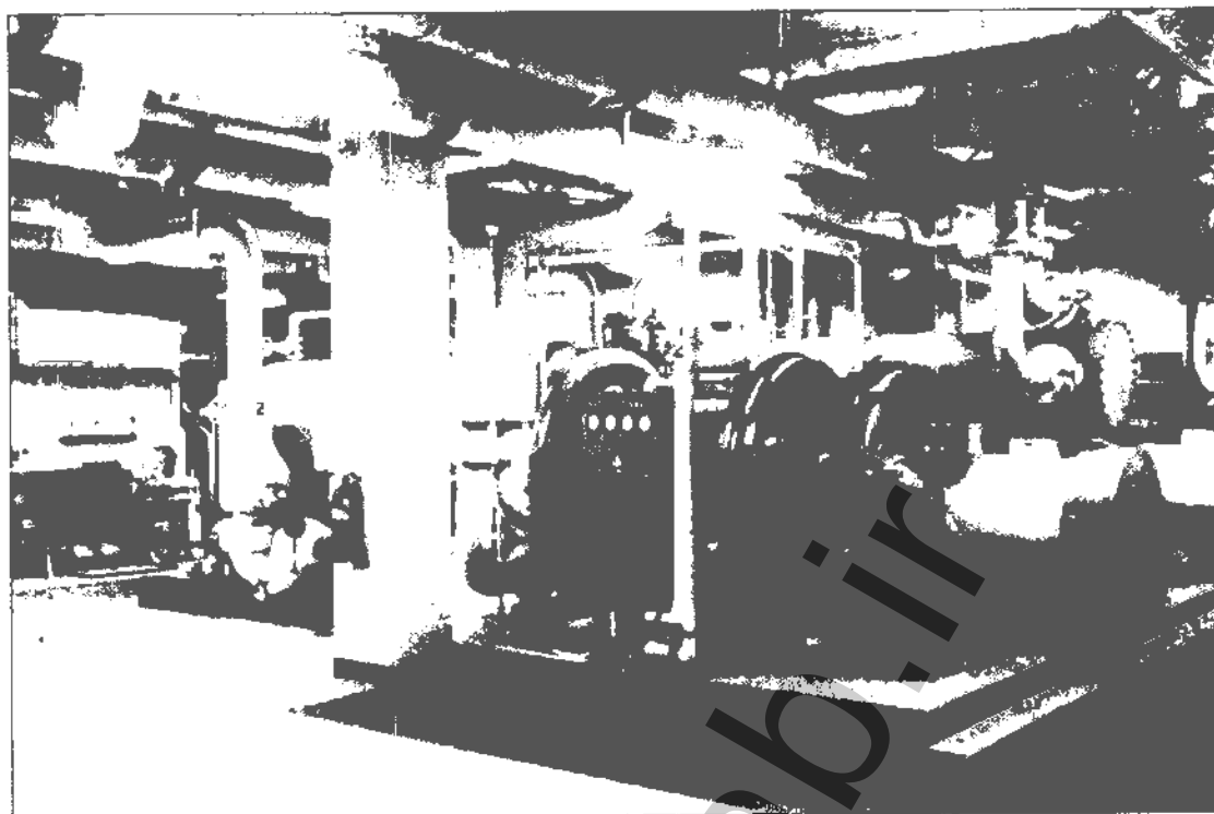
شکل ۷-۱. اتاق تاسیسات مرکزی برای یک سیستم تهویه مطبوع بزرگ. یک کمپرسور سانتریفوژ (هواشرگriez از مرکزی) و دستگاه آب سردکن در سمت راست از وسط تصویر و دیگ‌های آب گرم در سمت چپ زمینه عکس قرار دارند. آب سرد و آب گرم با لوله‌کشی به واحدهای تهویه مطبوع مستقر در نزدیکی نواحی تحت کنترل انتقال می‌یابند.
